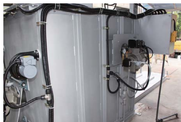
排ガス処理室用バーナー：温度による自動運転切り替え制御で 燃費の節約に貢献。
