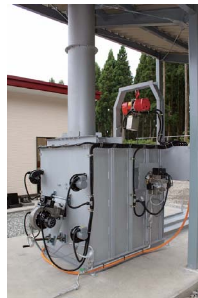
背面：(DEP-840R) バーナー2機、ブロー4機
